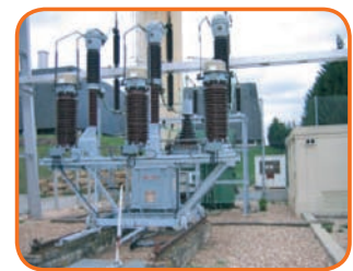
Disjoncteur à huile et Combiné de mesure
