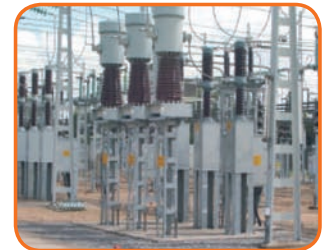
Disjoncteur SF6 et Combiné de mesure
